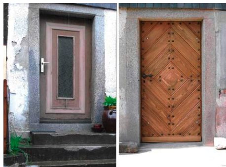
Stare nowe drzwi (po lewej) oraz nowe stare drzwi (po prawej). Przez wiele lat unikano renowacji zgodnej ze sztuką ochrony zabytków.
